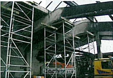
Einsturzgefahr: Die Halle musste provisorisch gesichert werden.
